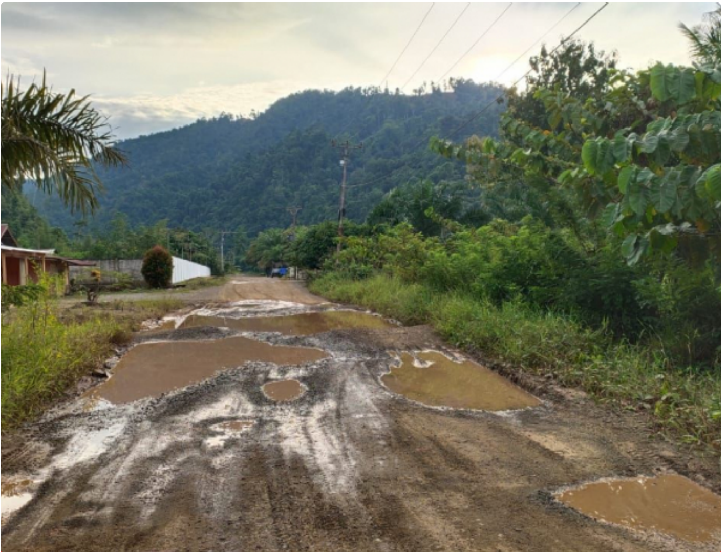
Tampak jalan poros Bimorjaya Mirip Kubangan Kerbau
